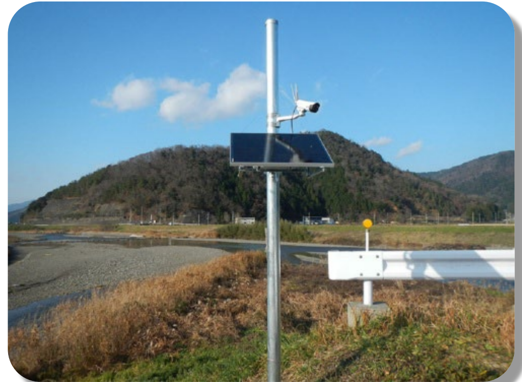
現場に導入された簡易型の河川監視カメラ (写真：気象工学研究所)
