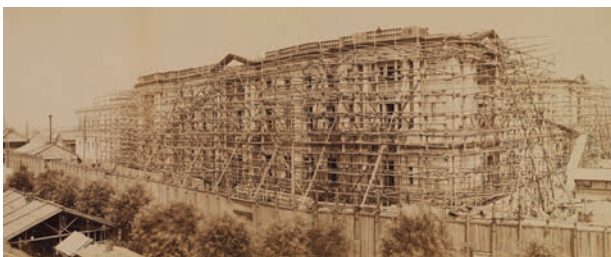
1895年8月14日 足場越しに外装工事をほぼ終えた本館の西側外観が見える。
