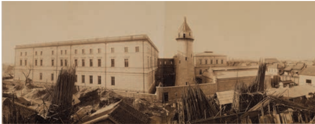
1896年1月18日 足場が外され、ほぼ完成した本館の東側外観。手前に取り外した足場材が積まれている。
