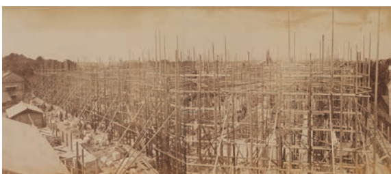
1891年9月1日 東南側から撮影。足場の中から、地下金庫の煉瓦積が見える。10月には首相ほか閣僚が視察に訪れた。地下階の石煉瓦積工事は同年12月23日に完了。
